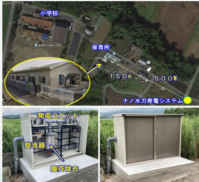
農業水利施設利用発電検証
